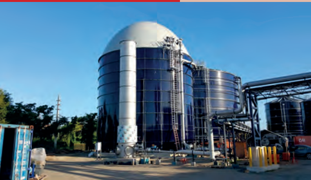
Usine de Biogaz ■ Puerto Rico
