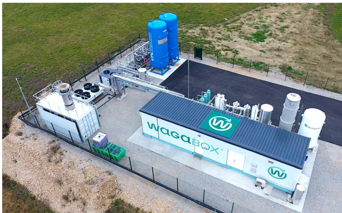
Fig. 9: L'unité WAGABOX® installée sur le site Suez de Les Ventes-de-Bourse
