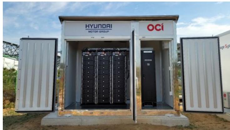
공주 태양광발전소 ESS 큐브
